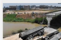
粤赣高速匝道坍塌
